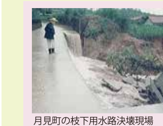
月見町の枝下水路決壊現場
